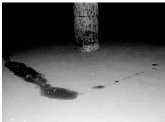
图 3 典型环柱裂缝及返潮
